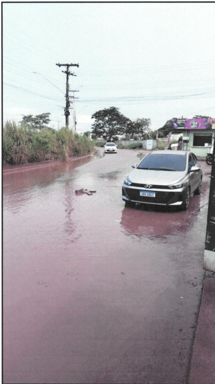
Fotografia 1 – Acúmulo de águas pluviais sobre a pista, comprometendo a circulação de veículos e oferecendo riscos aos usuários da via.
