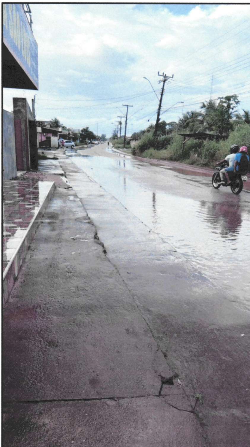
Fotografia 2 – Presença de lâmina d'água ao longo da pista, evidenciando deficiência no escoamento superficial das águas pluviais.
